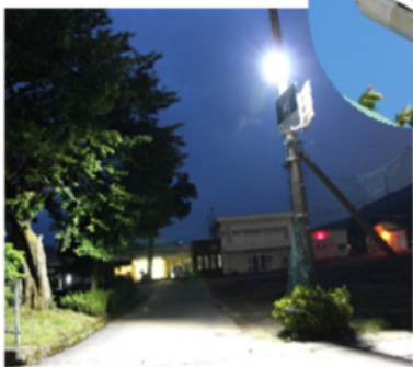
設置された防犯灯
